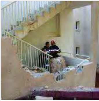
Falaise de Vitrolles : chute d'un bloc de rocher sur un immeuble d'habitation, 18 mai 2005 ( SDIS 13 )
