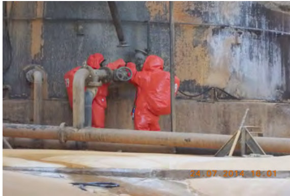
Fuite sur bac de stockage de soude 25/07/2014 Gardanne Auteur SDIS
