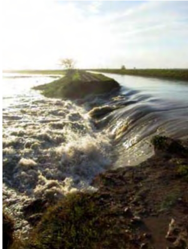
Rupture du Canal du Vigueirat (décembre 2003) auteur inconnu
