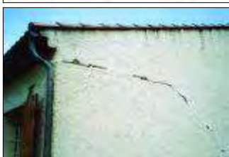
Fissure sur mur extérieur - BRGM
